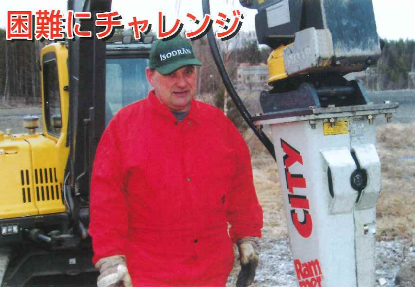
地元ディーラー マラコン社によって提供され、パライネン地区(フィンランド)での難しい解体工事に取り組みS23 CITY
